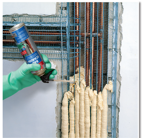
Dämmung von Heizrohren gegen Wärmeverluste.
