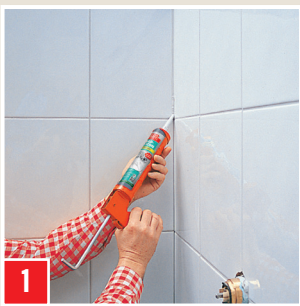
1 Dauerelastische Verschluss der Eckfuge.
