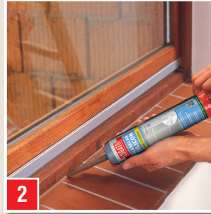
2 Versiegelung zwischen Fensterahmen und Sohlbank.
