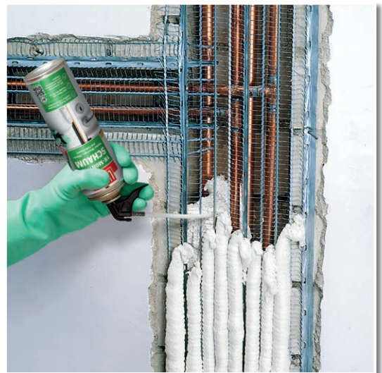
Wärmedämmung von Heizungsrohren.
